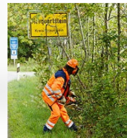
Verkehrszeichen müssen regelmäßig freigeschnitten werden, um die Verkehrssicherheit zu erhalten.
